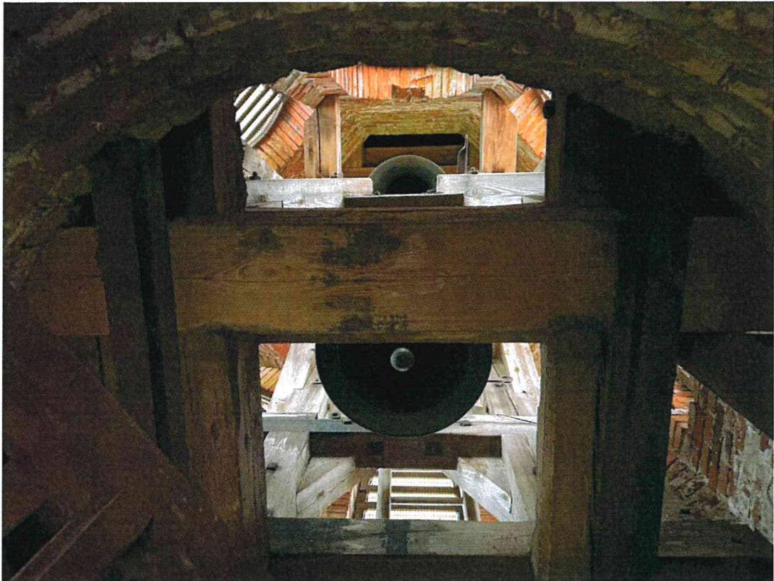
Fotografia 17. Sośno, kościół pw. Niepokalanego Serca Maryi w Sośnie, wewnątrz wieży, widok z II kondygnacji na III kondygnację.
