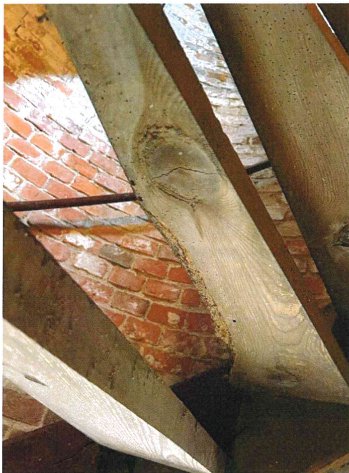
Fotografia 13. Sośno, kościół pw. Niepokalanego Serca Maryi w Sośnie, konstrukcja komunikacji klatki schodowej wieży, widoczne ubytki spowodowane działalnością owadów.
