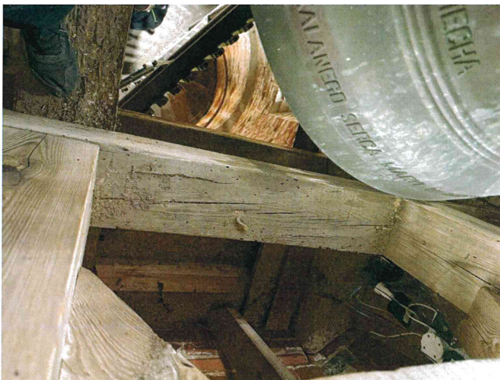
Fotografia 23. Sośno, kościół pw. Niepokalanego Serca Maryi w Sośnie, elementy konstrukcyjne dzwonnicy, widok z III kondygnacji na II kondygnację, widoczne ubytki spowodowane działalnością owadów. Fot. A. Kobus.
