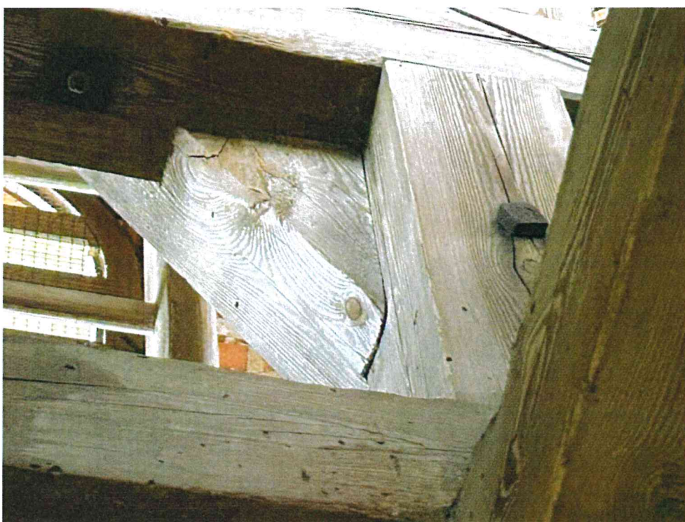
Fotografia 20. Sośno, kościół pw. Niepokalanego Serca Maryi w Sośnie, elementy konstrukcyjne dzwonnicy, widok z II kondygnacji na III kondygnację, widoczne ubytki spowodowane działalnością owadów.
