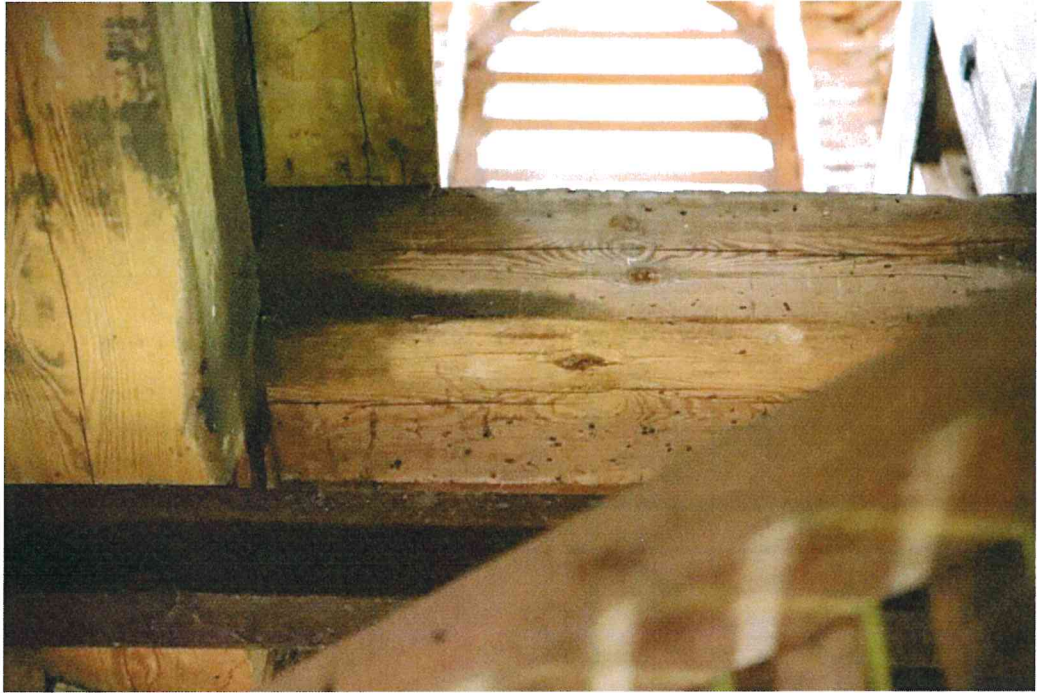
Fotografia 21. Sośno, kościół pw. Niepokalanego Serca Maryi w Sośnie, elementy konstrukcyjne dzwonnicy, widok z II kondygnacji na III kondygnację, widoczne ubytki spowodowane działalnością owadów.
