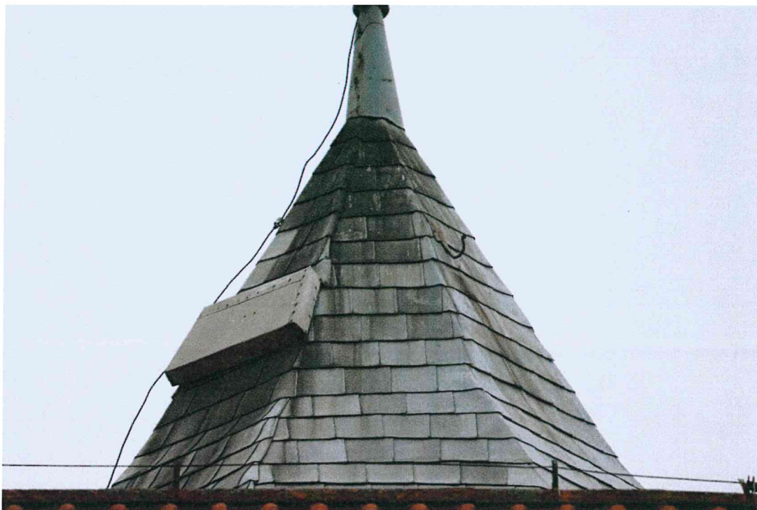
Fotografia 11. Sośno, kościół pw. Niepokalanego Serca Maryi w Sośnie, hełm wieży, widoczne zaplamienia.
