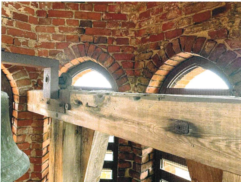
Fotografia 26. Sośno, kościół pw. Niepokalanego Serca Maryi w Sośnie, elementy konstrukcyjne dzwonnicy, widok III kondygnacji, widoczne ubytki spowodowane działalnością owadów. Fot. A. Kobus.
