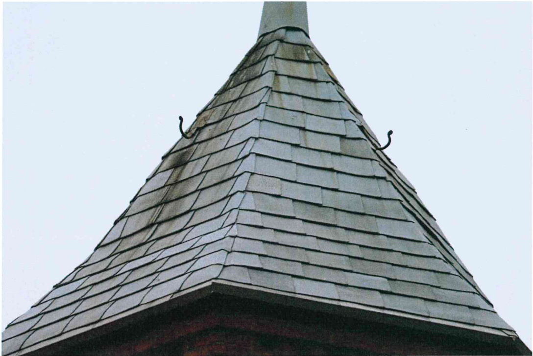
Fotografia 9. Sośno, kościół pw. Niepokalanego Serca Maryi w Sośnie, hełm wieży, widoczne zaplamienia.
