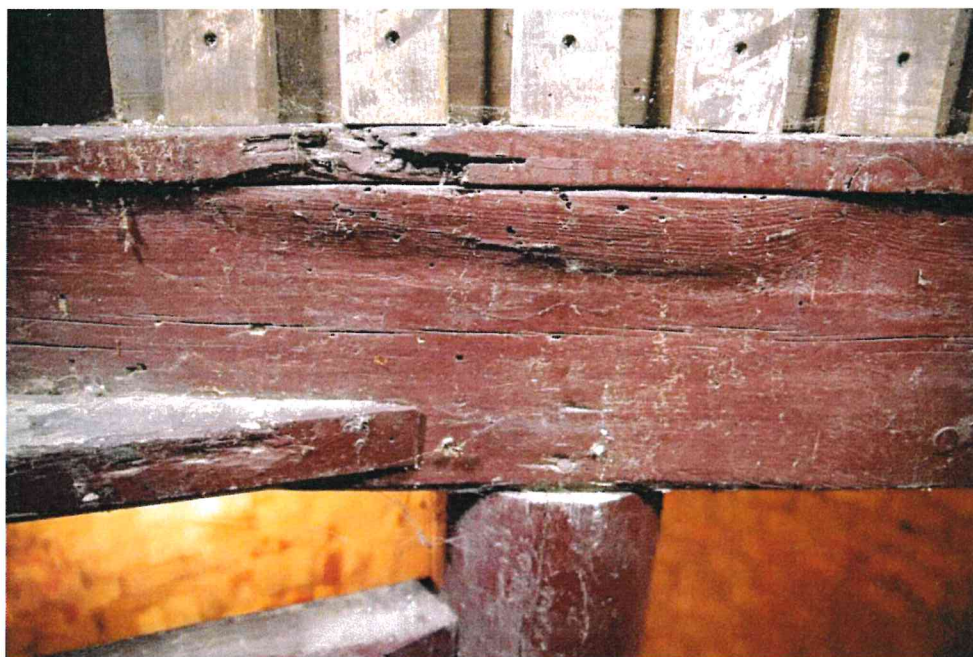
Fotografia 14. Sośno, kościół pw. Niepokalanego Serca Maryi w Sośnie, konstrukcja komunikacji klatki schodowej wieży, widoczne ubytki spowodowane działalnością owadów.
