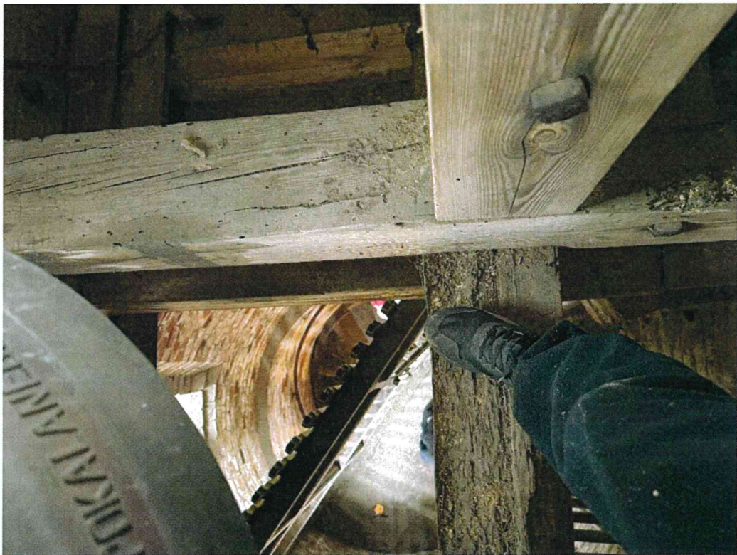
Fotografia 22. Sośno, kościół pw. Niepokalanego Serca Maryi w Sośnie, elementy konstrukcyjne dzwonnicy, widok z III kondygnacji na II kondygnację, widoczne ubytki spowodowane działalnością owadów. Fot. A. Kobus.
